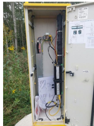
Kontrolės matavimų kolonėlė su nuotoline korozijos greičio daviklio matavimo įranga
